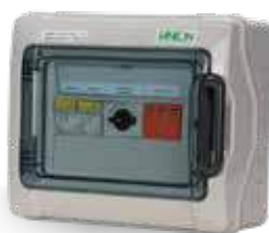
Quadri di stringa lato DC
